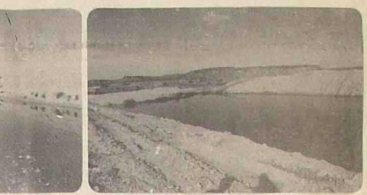
دو نمونه از استخرهای ایجاد شده در جزیره لاری جهت جمع آوری آب باران توسط پیمانکار برای تهیه آب مورد نیاز عملیات ساختمانی
